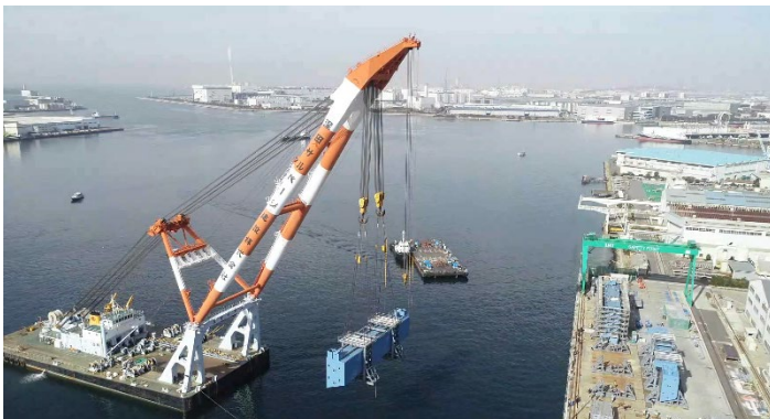
▲大阪堺の工場から閉伊川水門のゲートを輸送用の台船に積み込む様子
