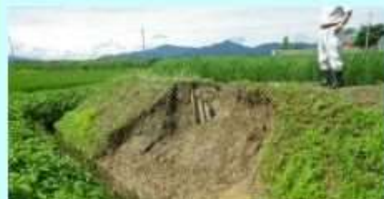
水路法面の崩壊
