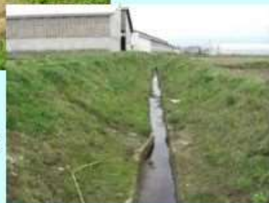
水路側壁の倒壊
