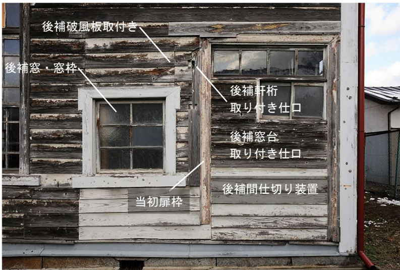
図 61 南面北寄りの状況 後補と思われる渡廊下が接続していた痕跡が見られる。
