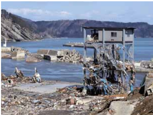
破壊された防潮堤、鉄筋がむき出しとなった水産施設
