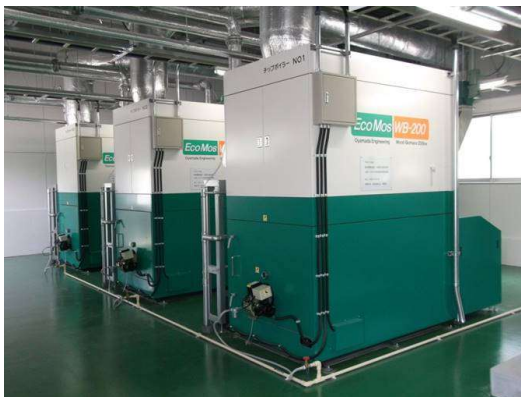
【いわて型チップボイラー】
