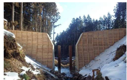
【治山ダム（スリット型）】
