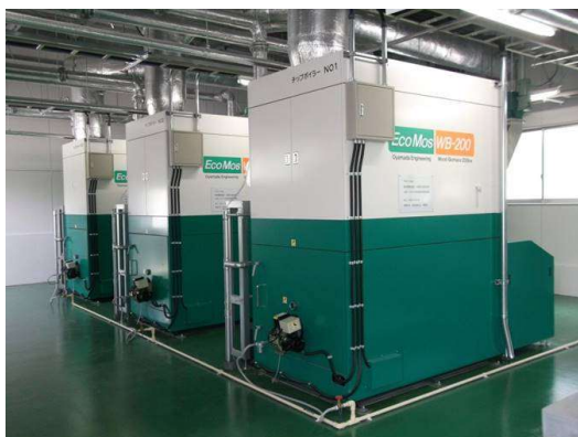
【いわて型チップボイラー】
