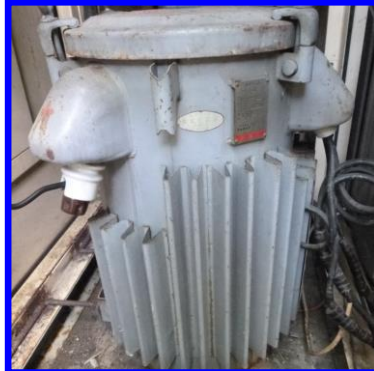
トランス（変圧器）
