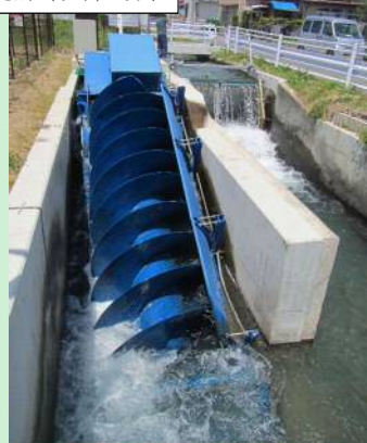
小水力発電所（水車）写真
