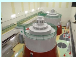
岩洞第一発電所
