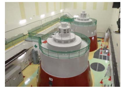
岩洞第一発電所
