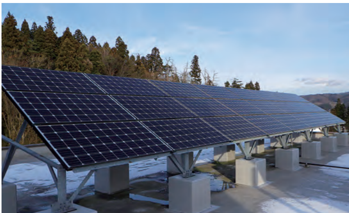
県南施設管理所に10kWの太陽光発電設備を設置しています (平成26年設置)。発電した電気は全て施設内で使用され、電力使用に伴う環境負荷低減に貢献しています。
