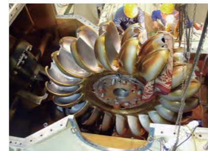
ペルトン水車（松川発電所）
