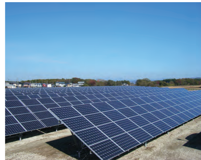
太陽電池モジュール
