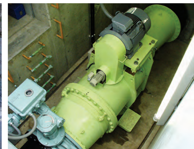
北ノ又第三発電所 水車発電機
