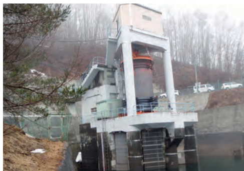
【写真】岩洞取水口
