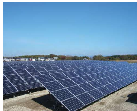
太陽電池モジュール
