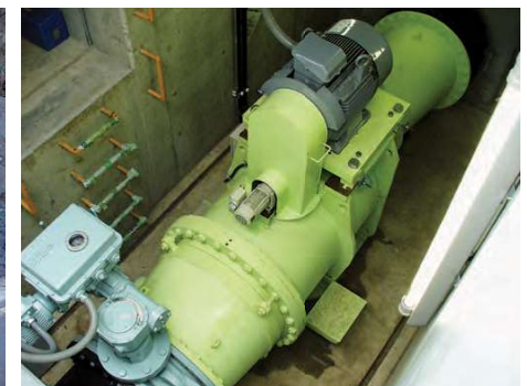
北ノ又第三発電所 水車発電機
