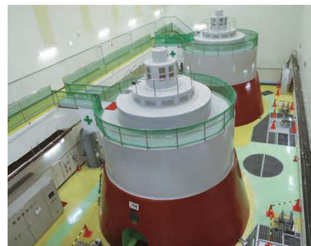
岩洞第一発電所・発電機
