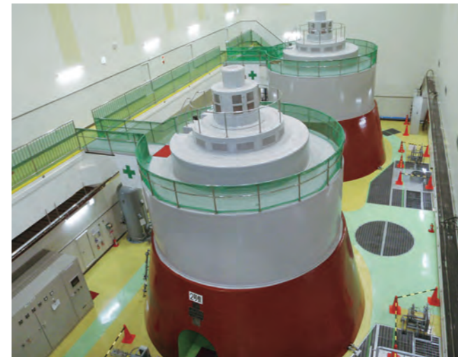
岩洞第一発電所・発電機
