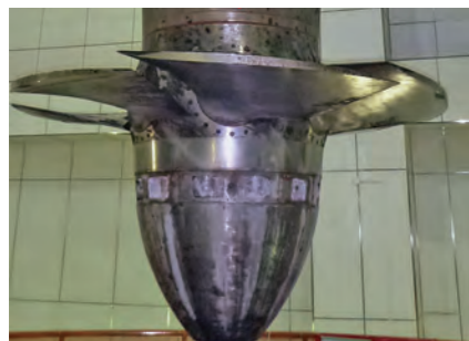
カプラン水車（四十四田発電所）
