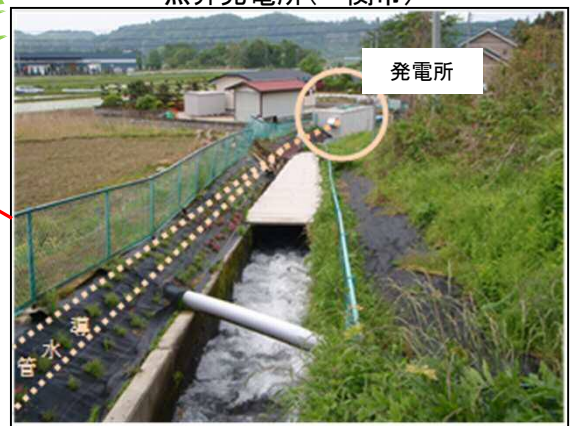
導水管の水でプロペラを回転させて発電
