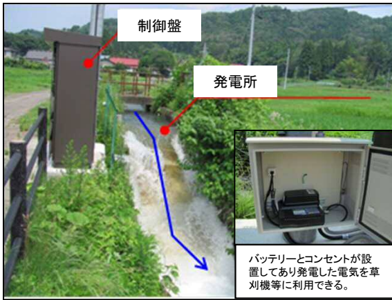
急流工の落差で発電
