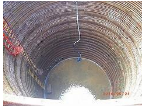
・ J 地区に新たに設置した大型集水井戸
