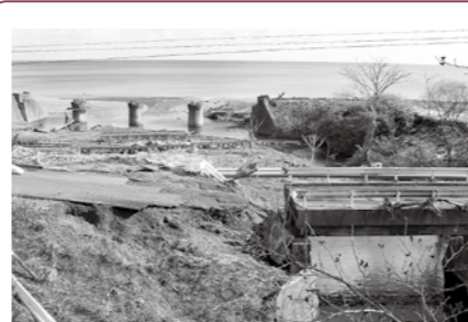
JR八戸線の鉄橋と町道大浜八木線の橋が崩壊(洋野町、3月12日)
