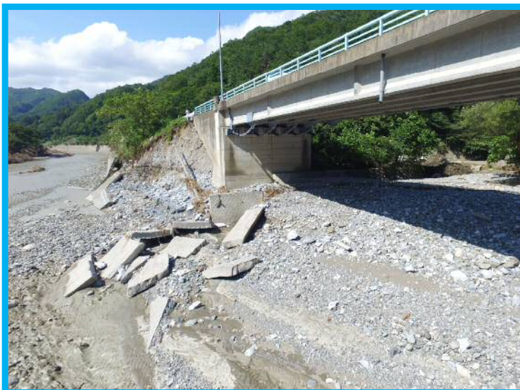
被災直後の状況(H28.9)
