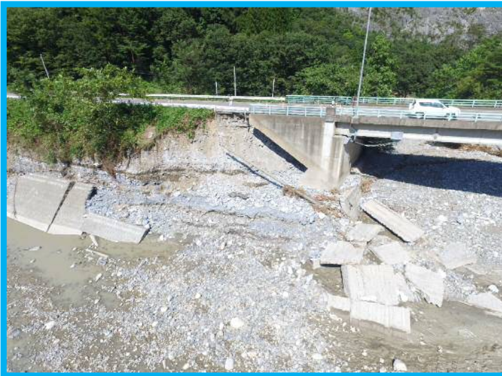
被災直後の状況(H28.9)
