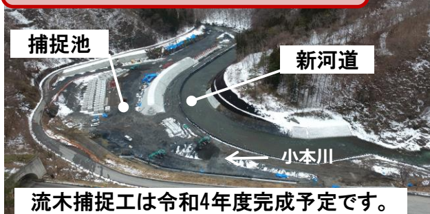
【小本川】 浅内工区流木捕捉工施設 (令和4年3月現在)
