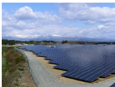
メガソーラー発電所
