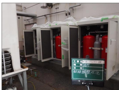
スプリンクラー設備
