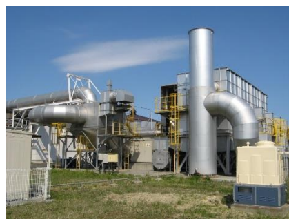
RTO 設置（蓄熱燃焼式排ガス浄化装置）
