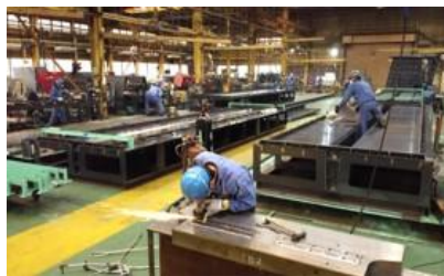
型枠製造ライン
