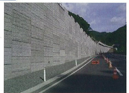
14~15号橋間道路改良 土を盛っ てコンクリートの壁でおさえます
