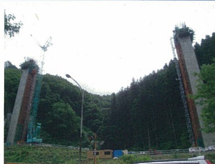
付替国道10号橋 大型クレーンで 材料を高さ50mまで上げます
