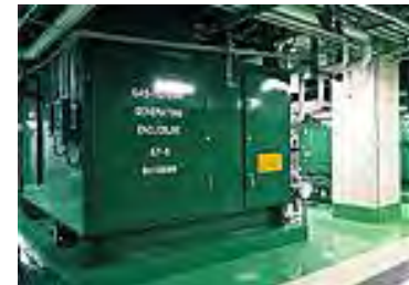
非常用発電設備
