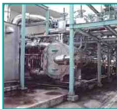
図 4-4 下水熱回収施設 (中川ポンプ場)
