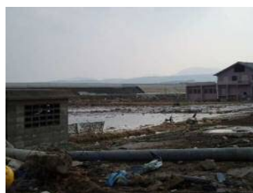
防潮堤背面の被災状況
