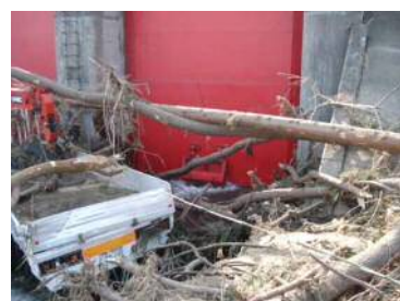
扉体の被災状況
