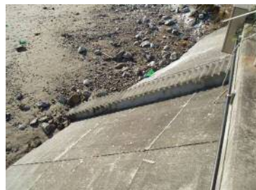
手摺の被災状況
