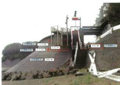
手摺の被災状況
