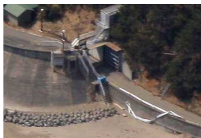
ガードレールの被災状況
