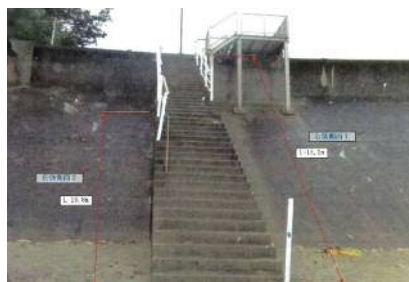
手摺の被災状況
