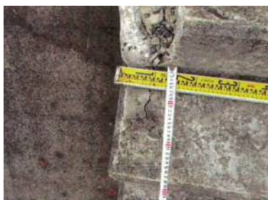
階段の被災状況
