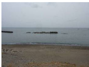
離岸堤の被災状況
