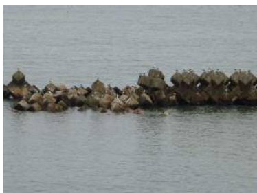
離岸堤の被災状況
