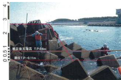
離岸堤の被災状況
