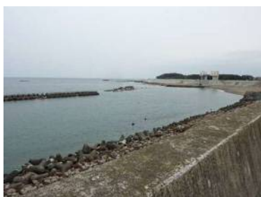
離岸堤の被災状況
