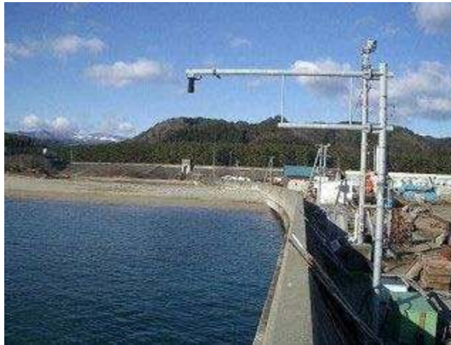
【資料 3-5-3 潮位監視システム】
