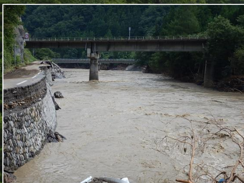
小本川の氾濫により道路が欠損 (平成 28 年 8 月 31 日時点)
