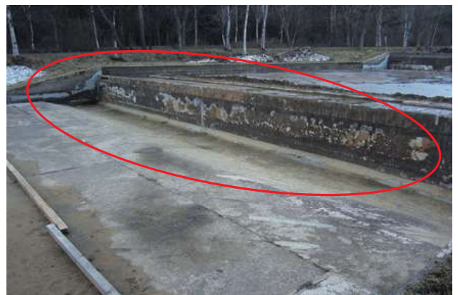
【後藤川温水路】対策工事前 コンクリートのすり減りが見られる
