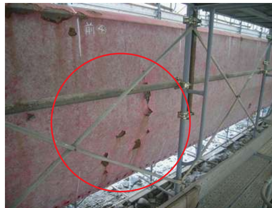
【瀬月内第一頭首工】対策工事前ゲートの塗装の剥離、鉄鋼の錆が見られる
