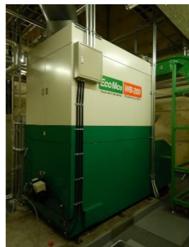
チップボイラー
