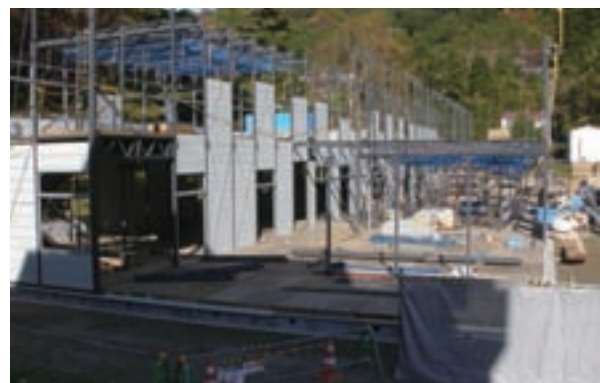
釜石市立唐丹小・中学校仮設校舎の建設現場(平成23年11月15日)
