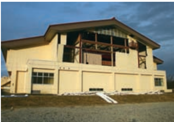
地震により壁や天井が落下した一関市立大東体育館（平成23年4月8日）
