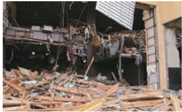
陸前高田市博物館内部の被災状況 岩手県立博物館提供
