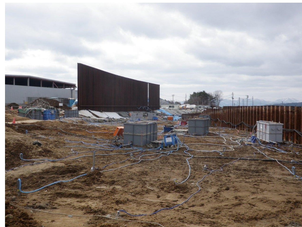
循環揚水設備設置状況
