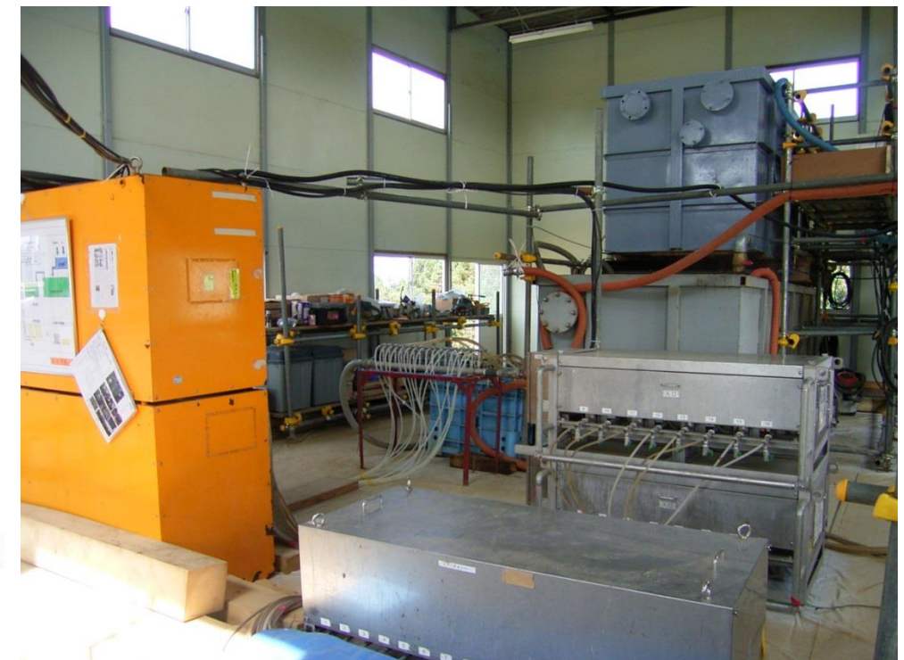
注入プラント
