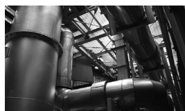
プラント配管
