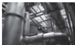
プラント配管
