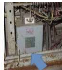
昇降機等の制御盤 (低圧進相コンデンサ)
