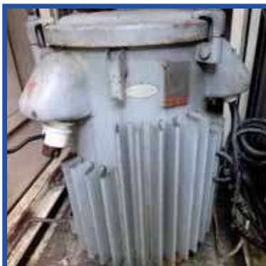
トランス（変圧器）
