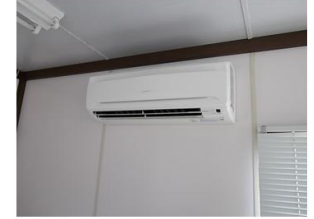
休憩所エアコン
