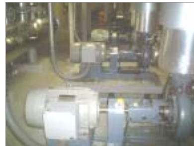
[空調熱源関係のポンプ類]
